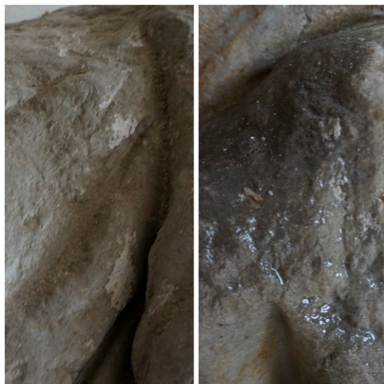
Fig. 4. Depuneri generate de factorul antropic – straturi de var și diverse mortare
