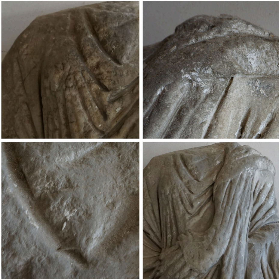
Fig. 2. Degradări la nivelul suportului – cruste negre, cruste de praf cimentat și depuneri diverse de mortar
