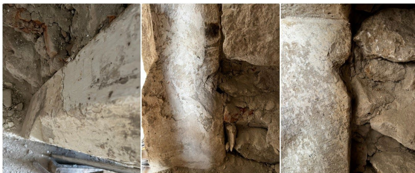
Fig. 6 – Detaliu al straturilor de vopsea exfoliate, respectiv cele două cavițăți de pe interiorul montantului stâng
