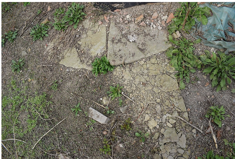
Fig. 10. Exfolierea gresiei paralele cu planul de fisuri - pierderi de material (drumul roman).
