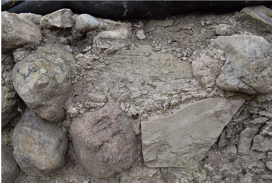
Fig. 11. Molon petrografic afectat de fisuri secante și paralele – zidăria paramentului.
