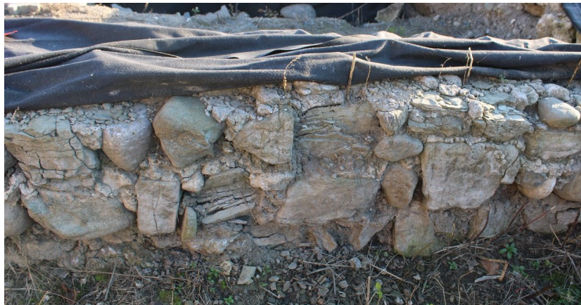
Fig. 18. Degradări la nivelul moloanelor de piatră și a mortarului dintre rosturi.
