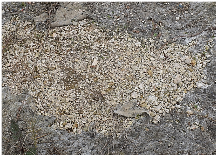
Fig. 17. Deteriorarea stratului cocciopesto – 2021.
