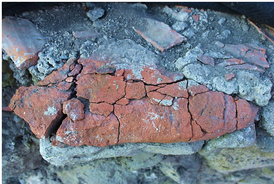
Fig. 12. Material ceramic afectat de exfolieri și fracturări ale suportului – zidăria paramentului.
