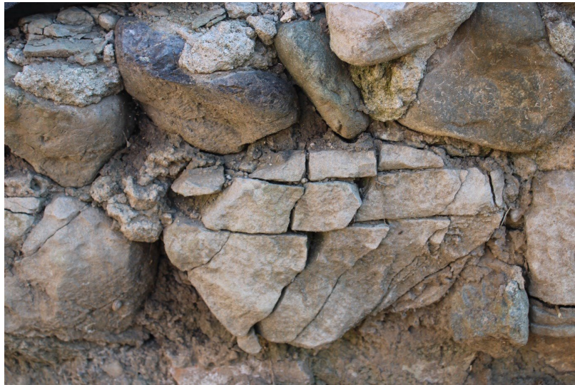
Fig. 19. Sisteme de fisuri - Fracturarea moloanelor de piatră.
