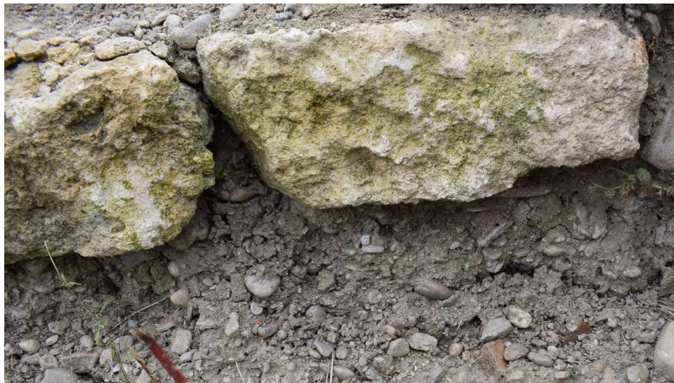
Fig. 20. Dezagregarea liantului din mortar – prăbușirea materialului din rosturile dintre moloanele de piatră.
