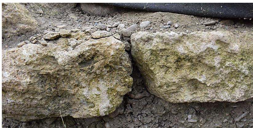
Fig. 22. Prezența atacului biologic activ la nivelul elementelor petrografice din zidărie.
