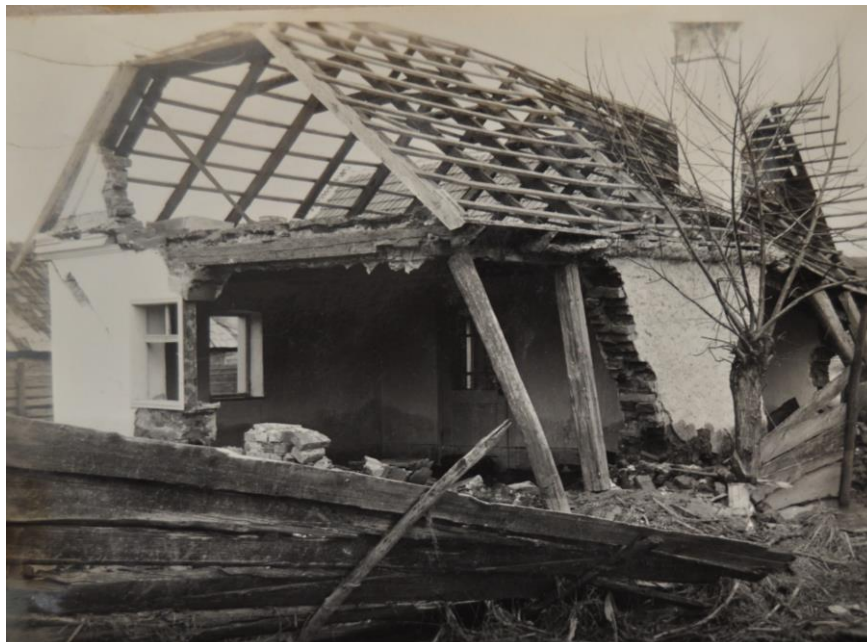
Foto 25. - Casă distrusă de inundații
